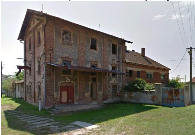
Foto 23: Pohled na plochu P02 se zchátralým mlýnem.
